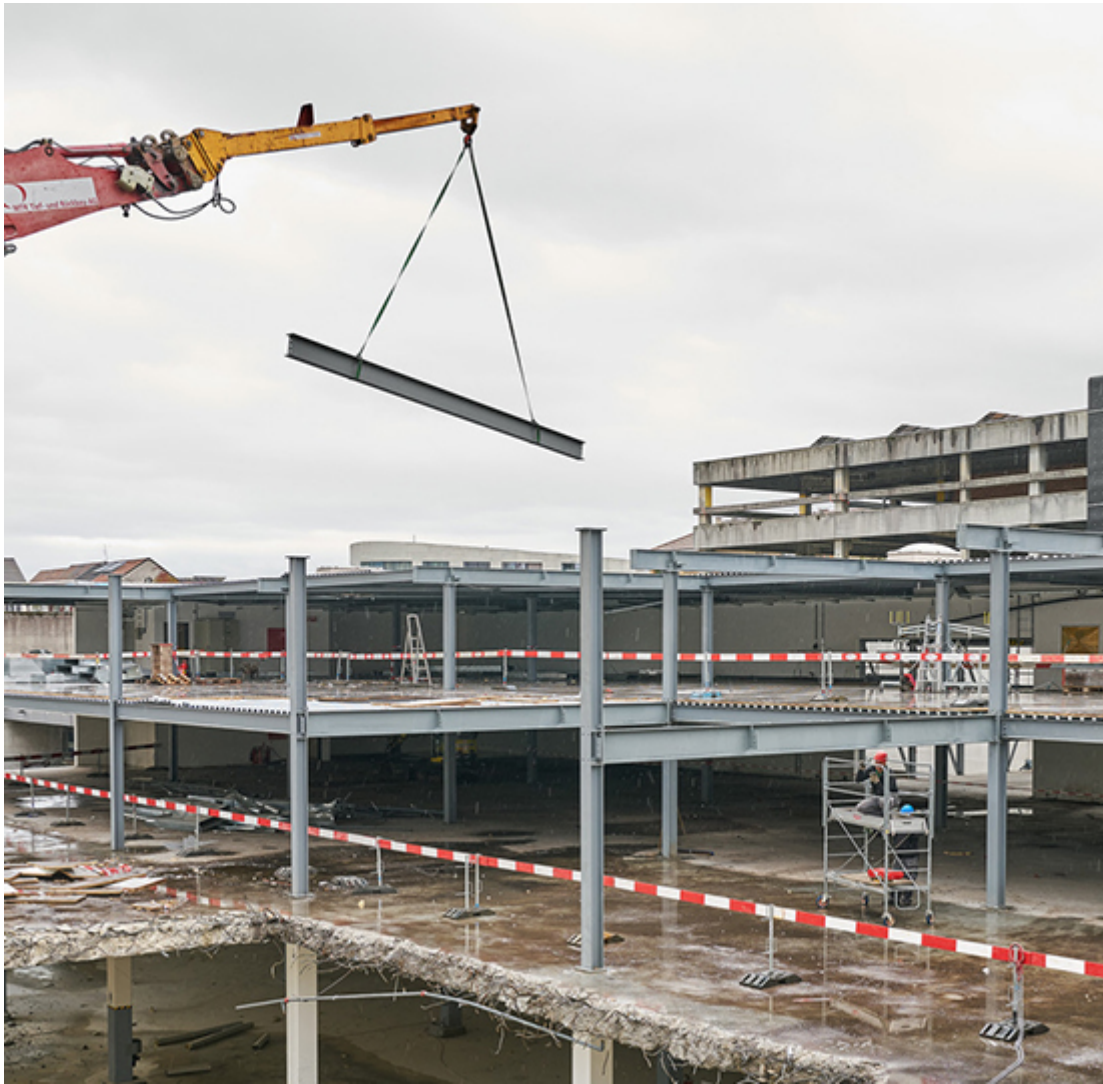
Stahlträger werden beim Abbruch der Coop Verteilzentrale in Basel gesammelt / Foto: baubüro in situ
