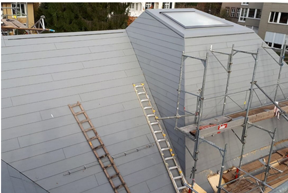
PREFA Prefalz-Aluminiumdachsystem, Kindergarten Paradiesstrasse, Riehen, Miller & Maranta 2018
