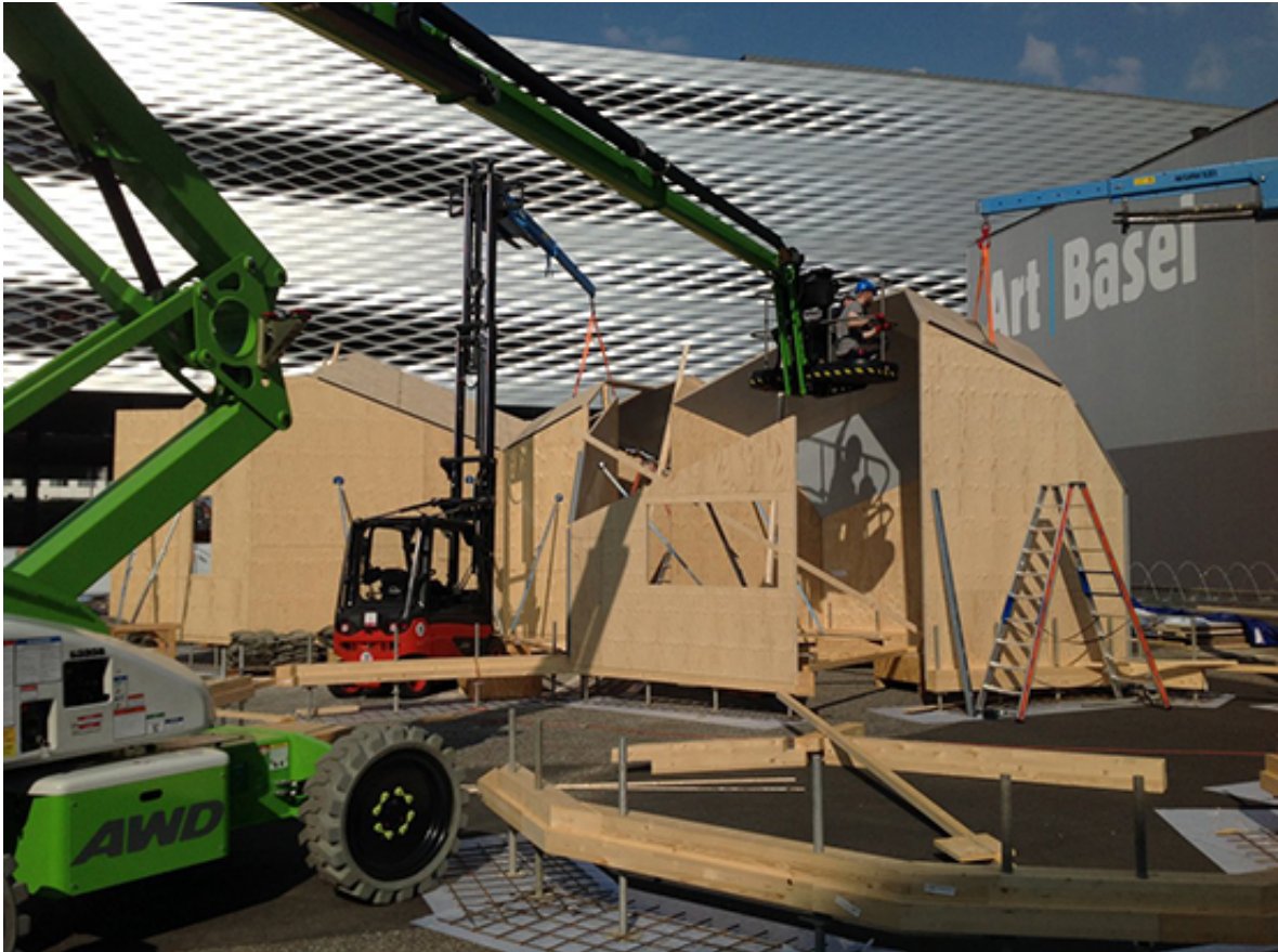
Aufbau an der Art Basel Juni 2016, im Hintergrund die Fassade von Herzog de Meuron
