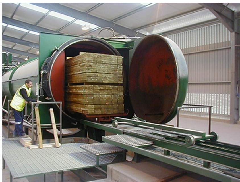
Druckkessel für automatische Imprägnierung, Imprägnierwerk Willisau
